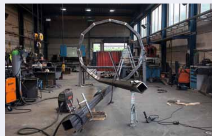
In der Halle der Stahlbaufirma Berkenkamp nahm das Lichtkunstwerk tagelang den ganzen Raum ein.
